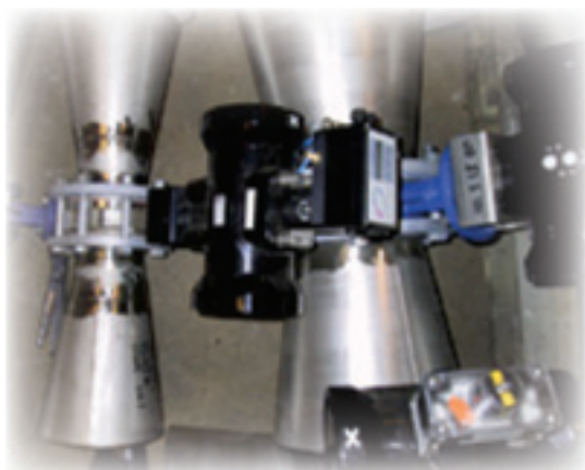
Central eléctrica (Finlandia) Power plant (Finland)
